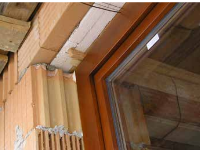
Chybné osazení okna za tepelným izolantem
